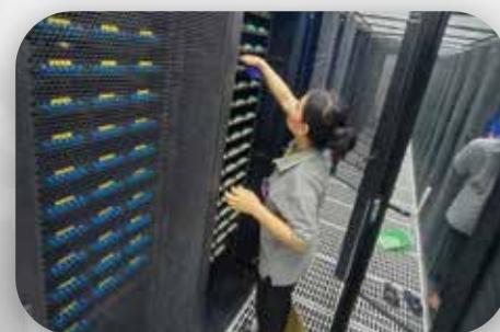
ทำความสะอาดห้อง Server
