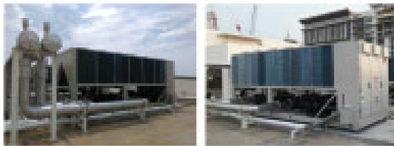
โรงพยาบาลสมเด็จฯ ณ ศรีราชา เปลี่ยน Air Cooled Chiller
