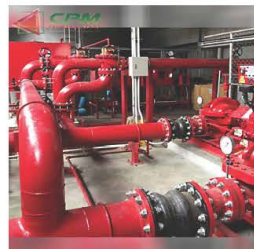
ระบบดับเพลิง Fire Protection System
