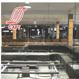
ระบบปรับอากาศ Air Conditioning System
