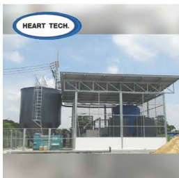
ระบบผลิตน้ำประปา Clarifier 30 m3/ hr.
