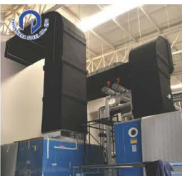
งานท่อดูดควันเชื่อม งานหุ้มฉนวนและเจ็ท เก็ต และงานระบบระบายอากาศ Extraction Arm and Insulation Work
