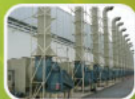
Hệ thống lọc không khí bằng nước
